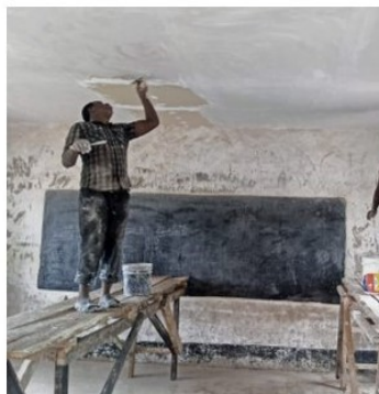
Wasserflecken und undichte Zimmerdecken müssen immer wieder ausgebessert werden.
